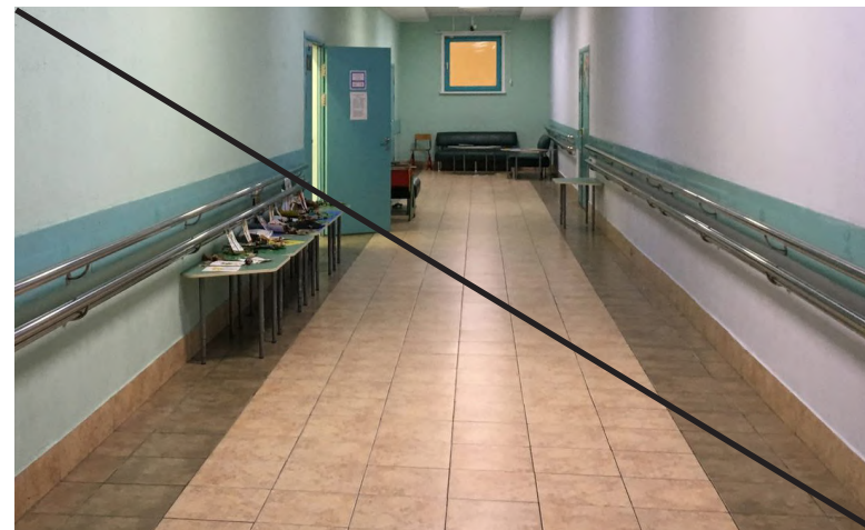
Плохо Керамогранитная плитка с крупными швами
