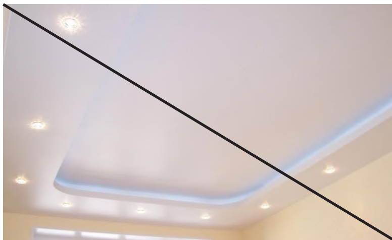
Плохо Многоуровневые гипсокартонные конструкции
